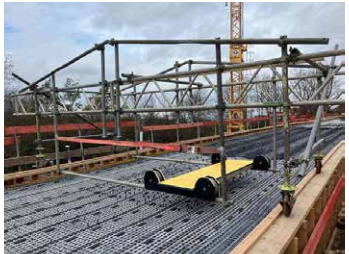
Foto Konrad Fuchs, Bewehrungseinbau unter Hilfe verschiebbarem Gerüst, da die Carbonbewehrung nicht betreten werden darf
